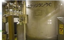
スラッジタンク
